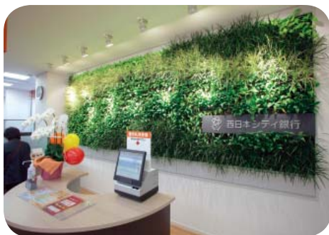
屋内壁面緑化設備（新宮支店）
