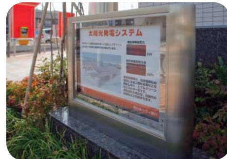
発電量表示パネル（折尾支店）
