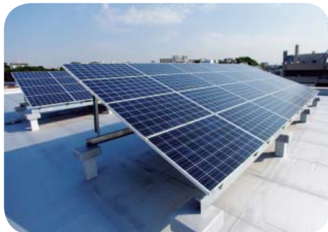
太陽光発電システム（折尾支店）
