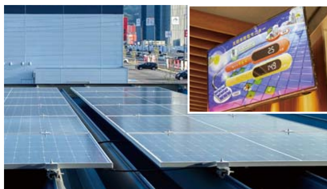
太陽光パネル、モニター
